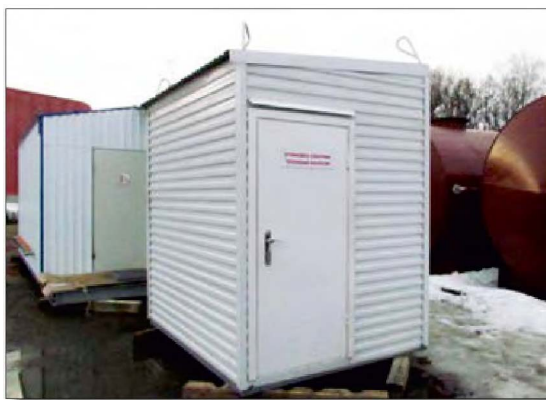
УСТАНОВКА ОБОГРЕВА ТЕПЛОМЫМ НАСОСОМ
